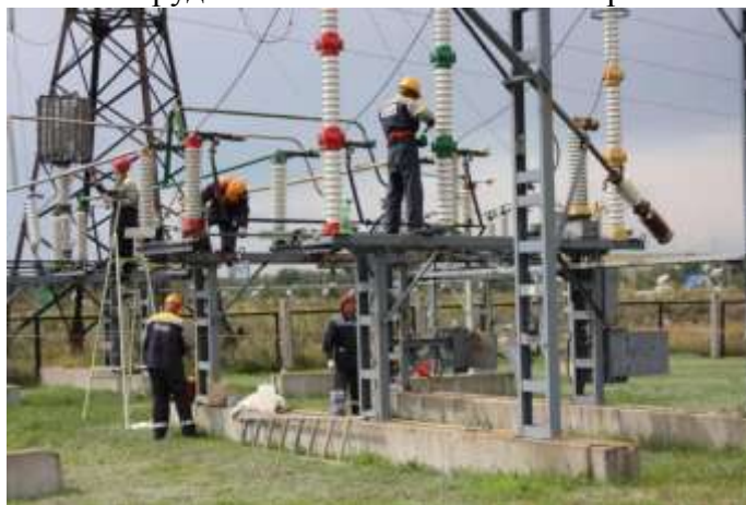
Рисунок 2 – Работа ремонтного персонала с нарушениями
